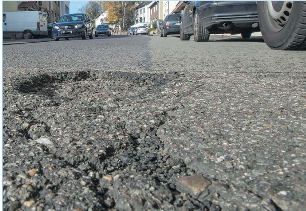
Vielerorts ein Problem: Winterschäden und miserable Zustände der Straßen Foto: jenal
